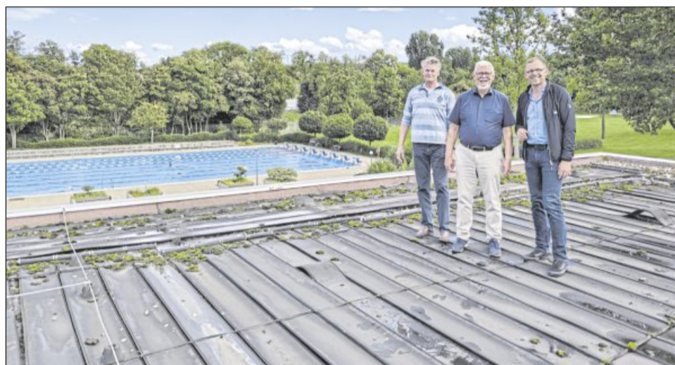
Die Solarthermieanlage für die Warmwasseraufbereitung auf dem Dach des Vaihinger Freibades muss dringend saniert werden. Für OB Uwe Skrzypek (rechts) ist diese Maßnahme alternativlos. Gemeinsam mit den Organisatoren der Energiewendetage Hans-Georg Hummel (links) und Helmut Randoll machte sich der OB ein Bild vom Zustand der Anlage. Foto: p
